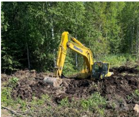
Рис. 7. Утонувший в охранной зоне ВОЛС гусеничный экскаватор, вызвавший повреждение ВОК гусеничным полотном
