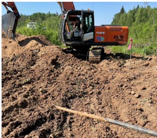
Рис. 6. Повреждение ВОК при проведении рекультивации грунта (уборка кустов) в охранной зоне ВОЛС вдоль а/д Няндомы-Каргополь. На фото видно, что на данном участке проводился технадзор – установлены метки прохождения трассы
